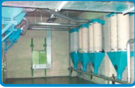
Havalandırma sistemindeki toz toplayıcılardan atık toplama
